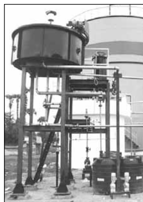
Figura 5. DAF (flotación de aire disuelto)
