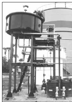
Figura 5. DAF (flotación de aire disuelto)
